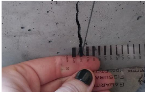
FIGURA 1. Medição de fissura com fissurômetro.
